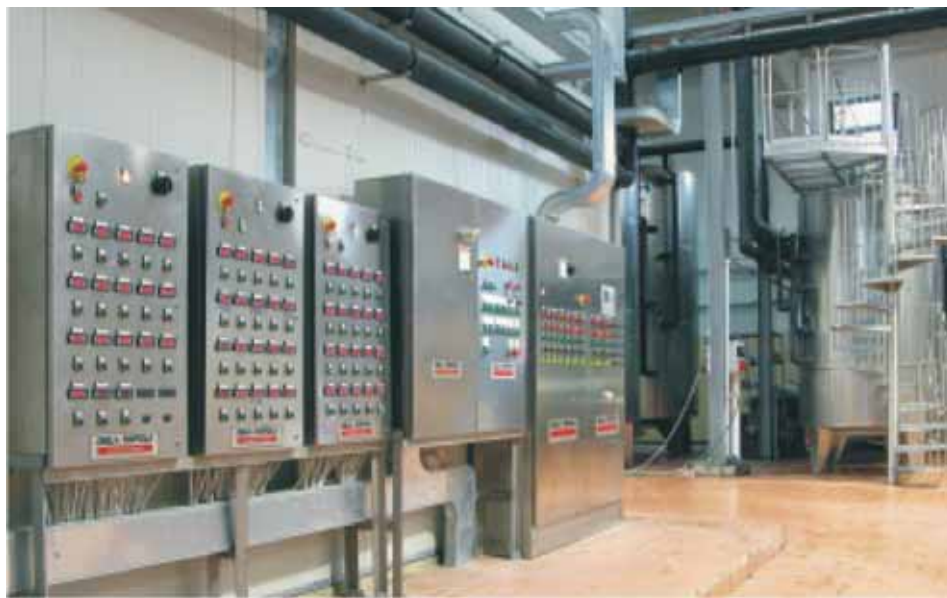
Foto 6. Quadri di controllo gestione temperature-Temperature control boards-Schaltschränke für die Temperaturregelung Tableau de contrôle et de gestion des températures-Cuadros de control y gestión temperaturas
